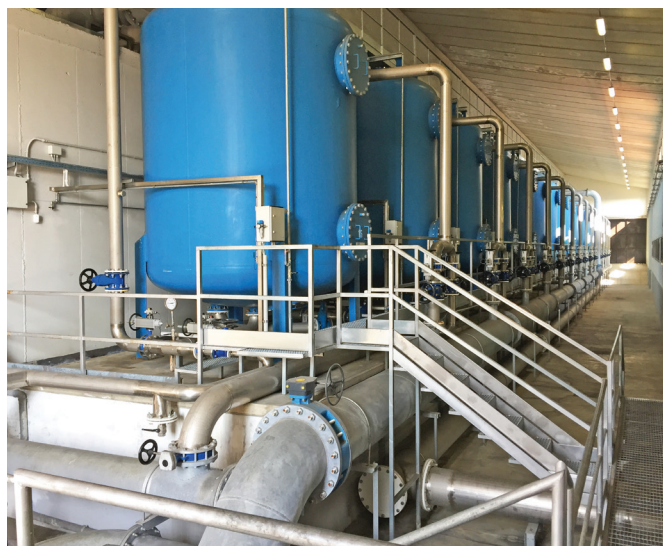
▲ Panoramica dei serbatoi pozzi
