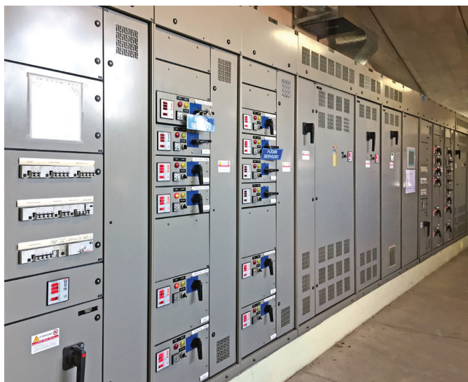
▲ Panoramica dei quadri di potenza
