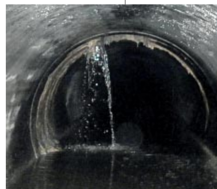
FIG. 1: INFILTRAZIONI ANOMALE IN CONDOTTA
