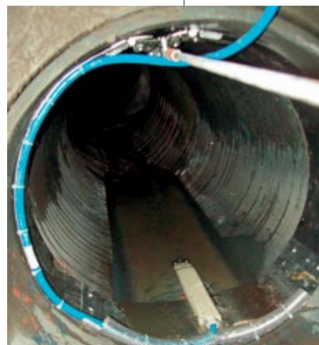
FIG. 2: INSTALLAZIONE STRUMENTAZIONE AREA-VELOCITY IN CONDOTTA
