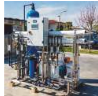
Impianto osmosi inversa su skid
