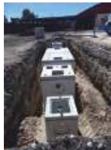
Vasche e sistemi di trattamento acque meteoriche in cemento
