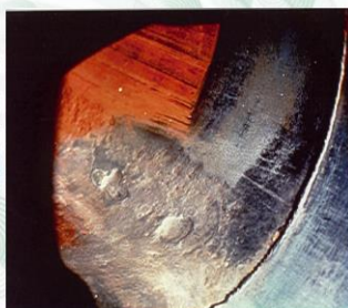
PROCESSO DI CORROSIONE INTERNA DA SOTTODEPOSITO VISIBILE DOPO LA PULIZIA PRE-ISPETTIVA
