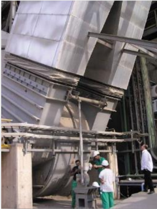
Motorizzazione di una grande serranda - Cementificio -
